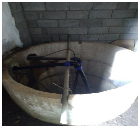
Figura 4 – Bomba de extração de água da captação subterrânea.
