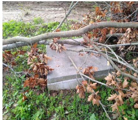
Figura 10 – Caixa de receção dos chorumes provenientes do Pavilhão C.
