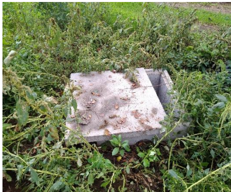
Figura 9 – Caixa de receção dos chorumes provenientes dos Pavilhões A e B através das fossas existentes à saída dos respetivos pavilhões.
