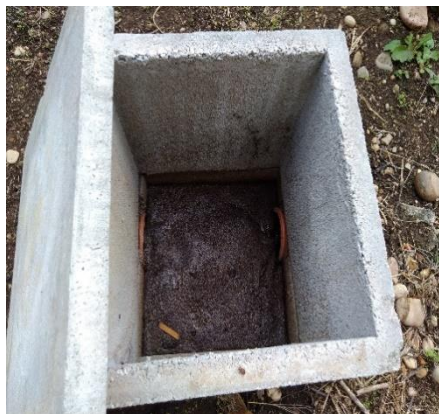
Figura 8 – Caixa exterior recetora das águas de lavagens do pavilhão.
