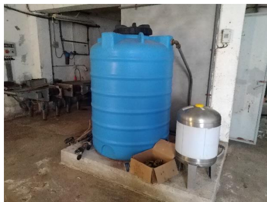
Figura.6 – Equipamento de receção e tratamento de água (1500 Lts) para abeberamento das aves instalados em cada pavilhão.
